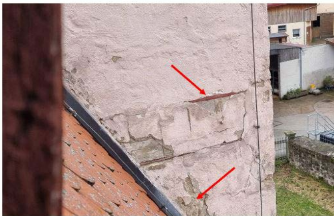
Bild 5: Korrodierte Stahlträger im Turmmauerwerk und Putzabplatzungen
