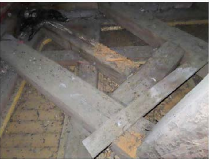
Bild 23: Schädigungsbeispiel und Feuchtigkeitsschaden in der Zerrbalkenlage des Turms
