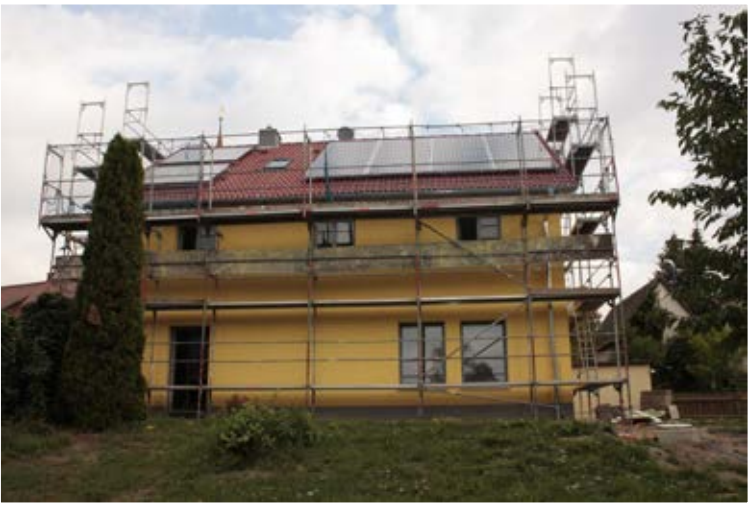
Die Photovoltaik-Anlage auf dem Schwander Pfarrhaus
